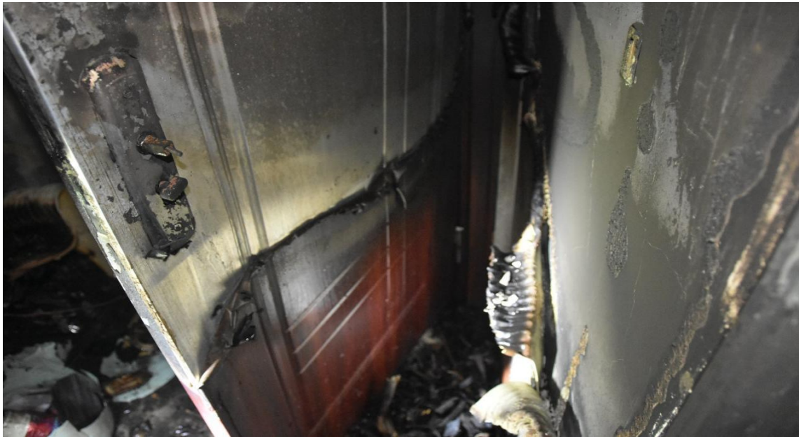
图片 3: C 卧室房门内外侧面上部均受热变色严重, 呈现“斜茬”痕迹, 斜茬低端指向 C 卧室内, 内侧变色重于外侧, 内侧门锁把手缺失 (由东南向西北拍摄)
