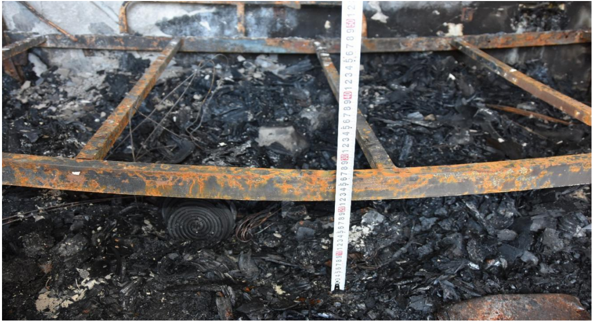
图片 6：下铺靠过道的床沿金属构件严重弯曲变形（最低点距地 22cm）（由东向西拍摄）
