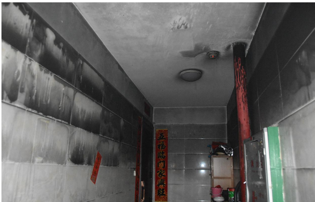
图片 1：某层公共通道临近某室顶棚烟熏严重，邻近某室过道顶部的感烟探测器指示灯常亮（由北向南拍摄）
