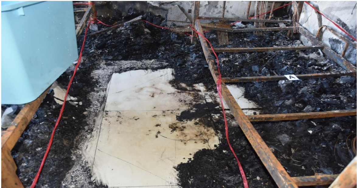
图片 9：清理后地面瓷砖未见液体流淌痕迹，在 A 网格金属床沿弯曲处附近的瓷砖表面有轻微裂痕，松动不明显(由北向南拍摄)
