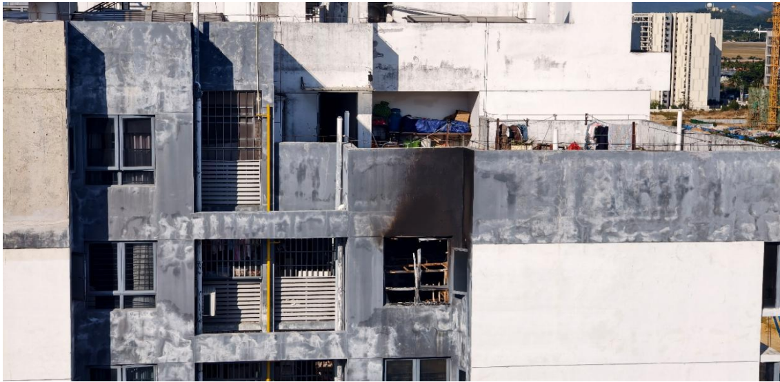
图片 2: 东侧卧室外墙上部有明显烟熏痕迹, 窗户南侧上部框架烧损较重, 室内有明显过火痕迹, 上下层未见过火 (由东向西拍摄)
