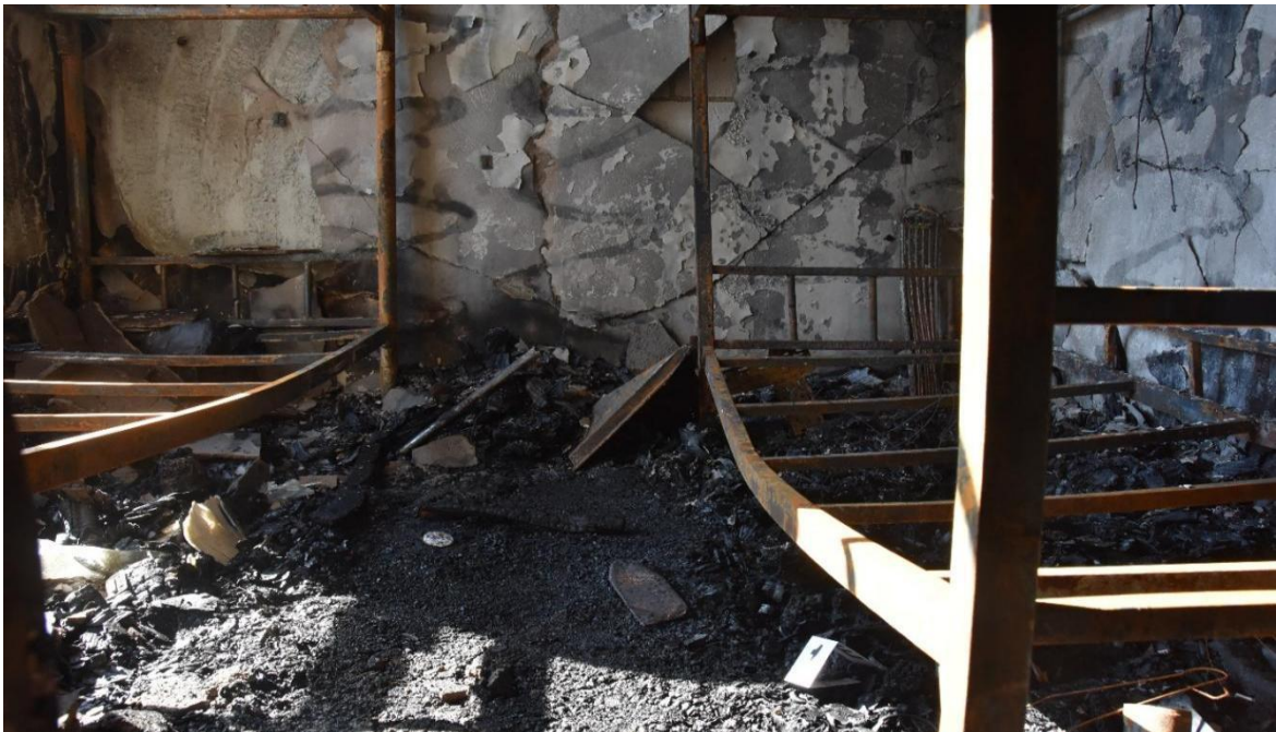
图片 5: 双层床床板和床上用品完全烧毁, 残留金属床架铁架床, 下铺靠过道的床沿金属构件严重弯曲变形(由北向南拍摄)
